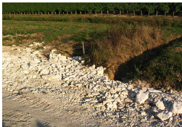
Dans le Secteur de Vaucoupin, avec les forts ruissellements dans les vignobles, les chemins viticoles sont détériorés et des ornières se créent au niveau des fossés. Pour maintenir le chemin en état, des apports de matériaux sont indispensables à la remise en état du chemin.
